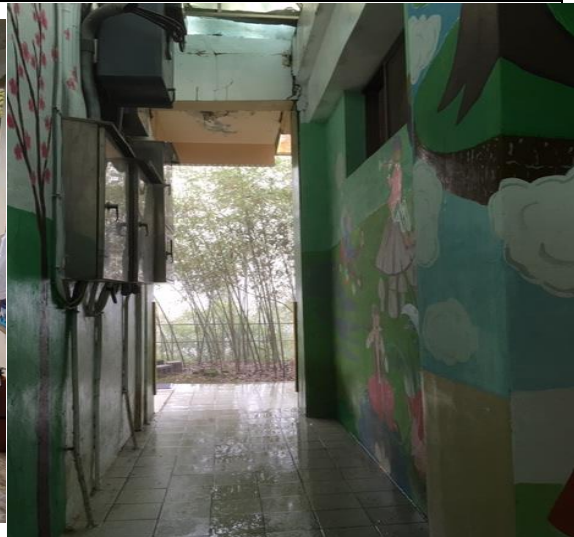
位置：廁所旁走道 說明：雨遮老舊漏水問題嚴重導致遇雨走道積水。
