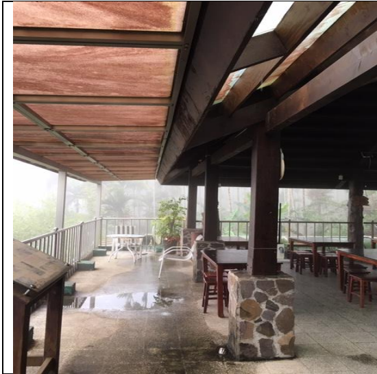
位置：桌球室外廊道 說明：雨遮老舊漏水問題嚴重導致遇雨走道積水。
