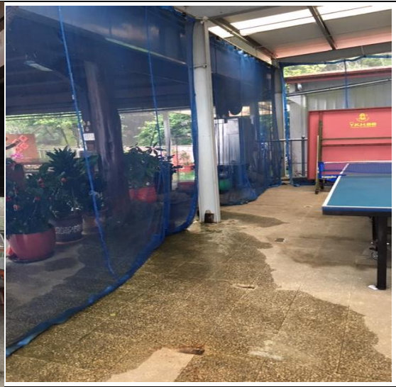
位置：桌球室旁 說明：雨遮老舊漏水問題嚴重導致遇雨走道積水。
